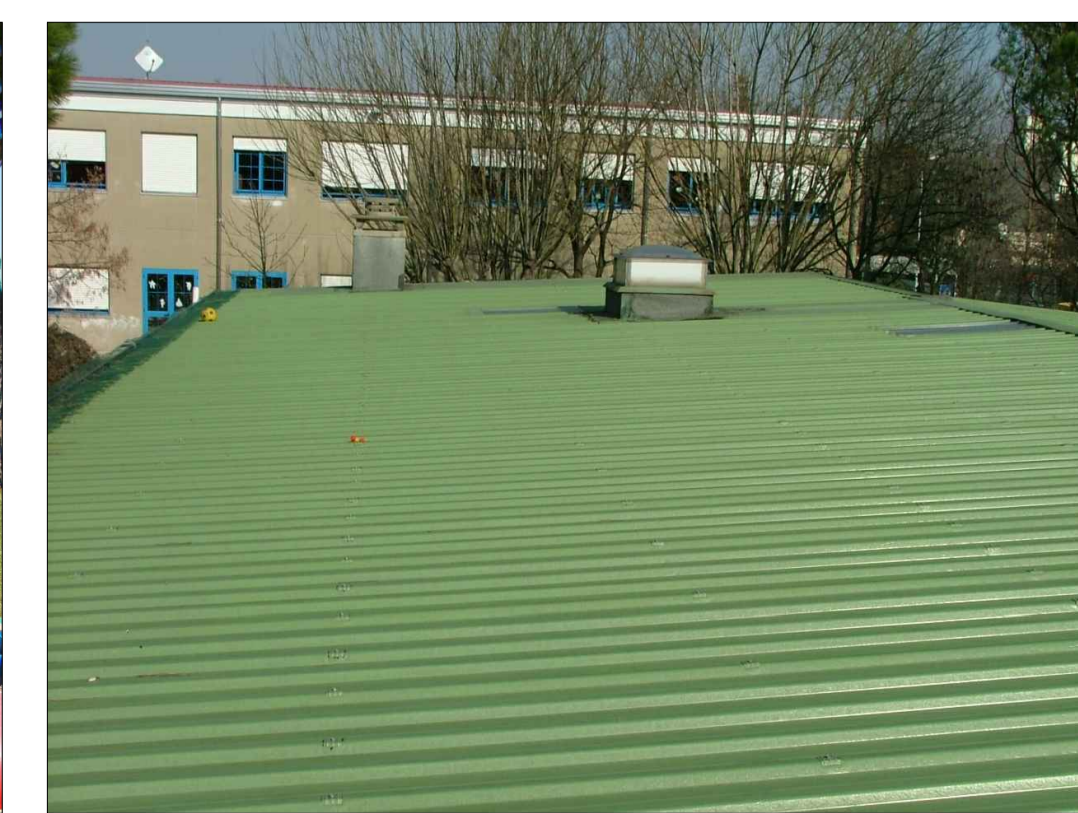
PANNELLI IN LAMIERA DI COPERTURA
